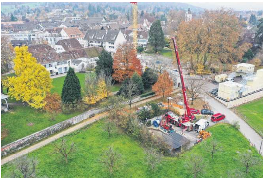
Luftbild zu Beginn der Arbeiten zur Einsetzung der neuen Förderpumpe und der Steigrohre beim Wasserentnahmeloach am Bachtelenweg. Foto: Tobias Frei
