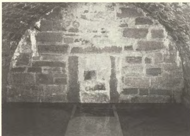
Brunnstube und Quellaufstoss der Moosquelle. Ein Objekt des ehemaligen Riehen- brunnwerks aus dem Jahre 1493.
