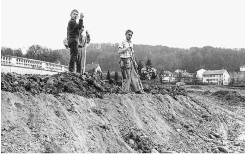
Erdbewegungsarbeiten im westlich der Bettingerstrasse gelegenen Teil des Wenkenparks (nach 1957). Im Hintergrund sind einzelne Häuser an der Rudolf Wackernagel-Strasse und am Rütiring zu sehen.
